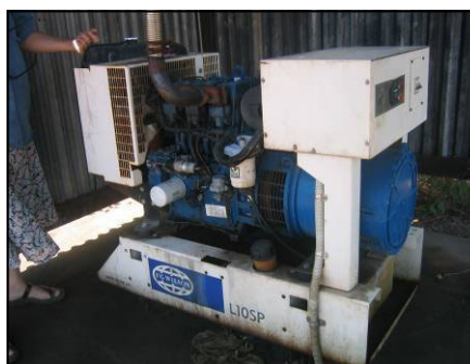
Gunun Woonun's Generator
